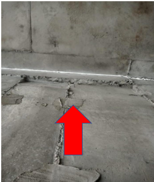
Figura 15 – Abaloamento da parede
