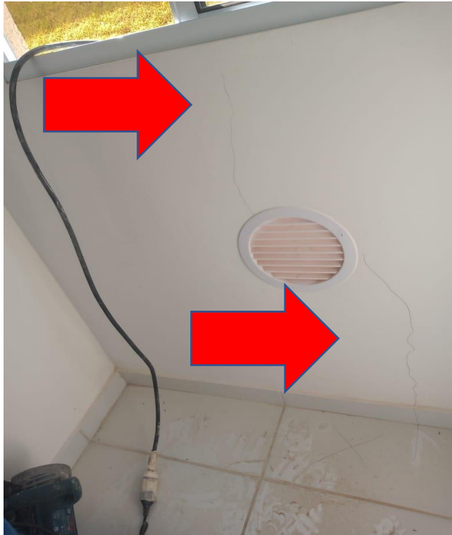
Figura 16 – Fissura na parede
