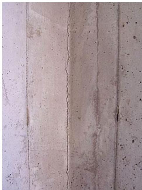
Figura 3 – Fissura em parede de concreto
