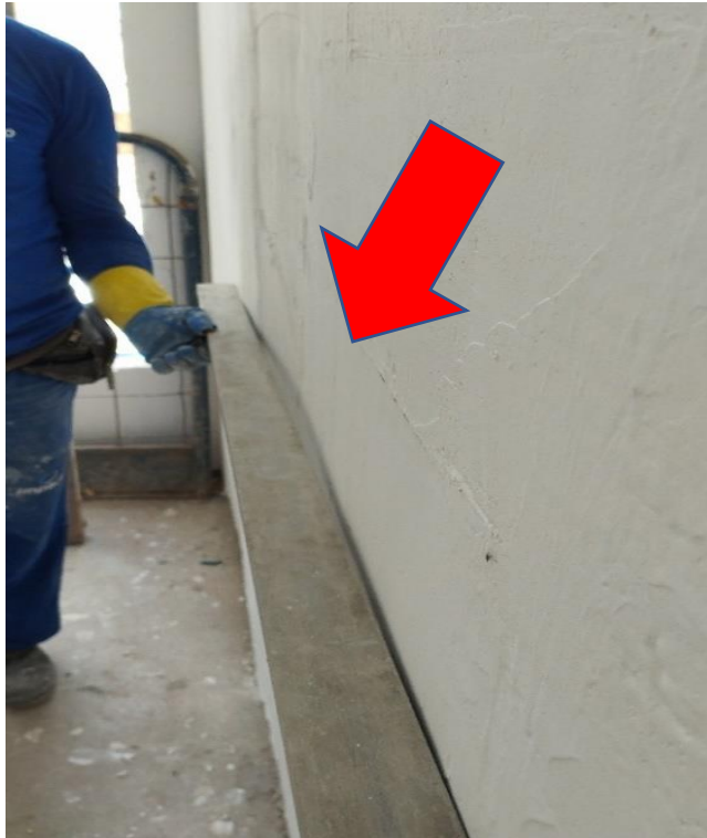
Figura 14 – Abaloamento da parede
