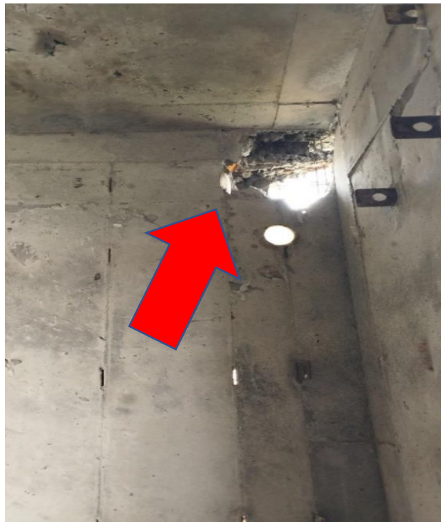
Figura 13 – Parede com segregação
