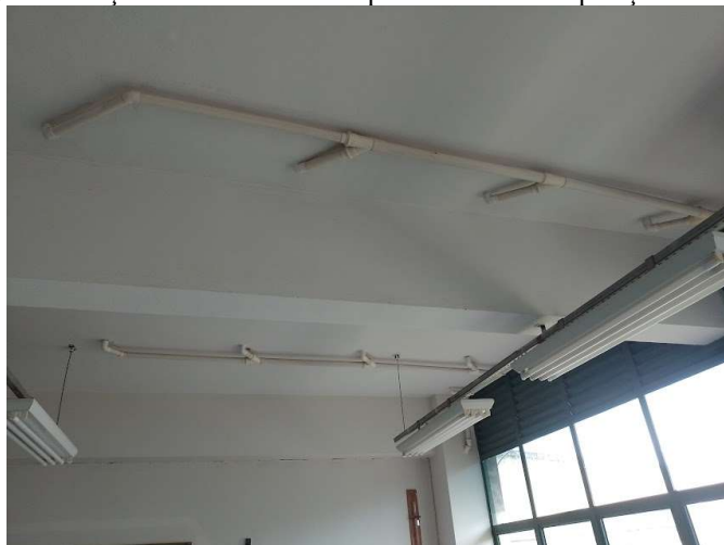
Figura 29: Tubulações hidrossanitárias aparentes no teto e posição das luminárias
