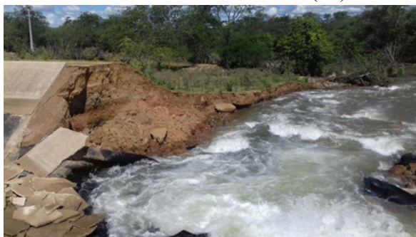
Figura 42 – Rompimento de estrutura no canal de transposição do rio São Francisco em Custódia (PE)
