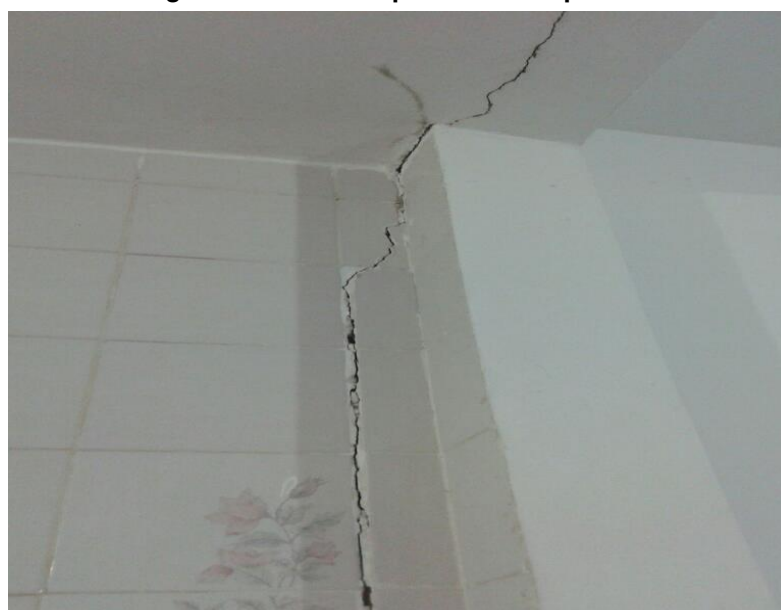
Figura 14 – Fissura presentes na parede.
