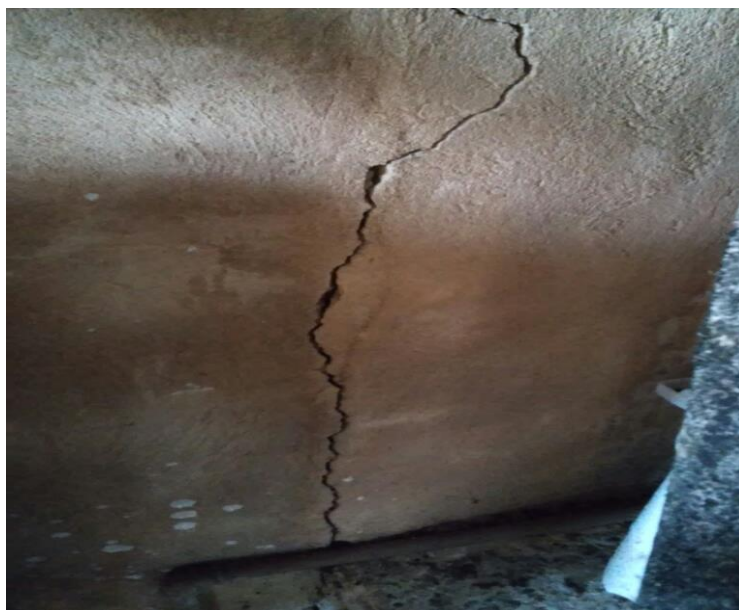
Figura 15 – Fissura presente no segundo pavimento.
