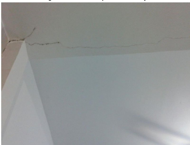
Figura 13 – Fissura presente na laje.
