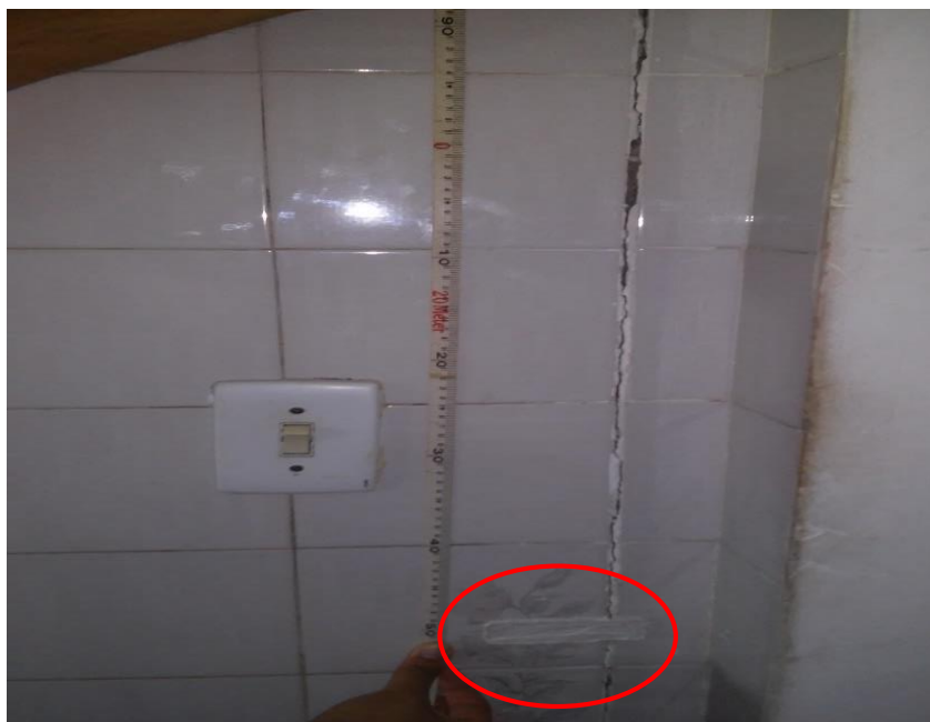
Figura 1 - Placas de gesso nas fissuras para monitoramento dos deslocamentos.
