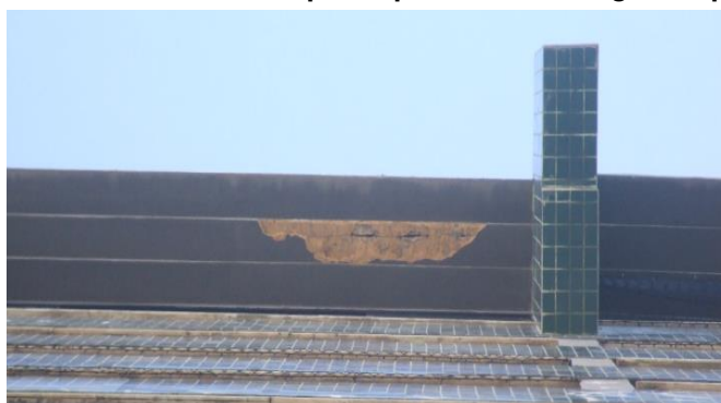
Figura 27: Destacamento por expansão da ferragem exposta
