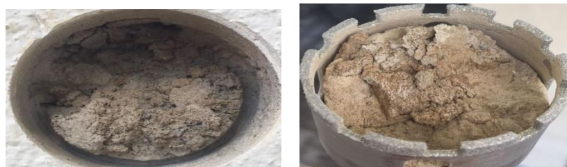
Figura 21: Corte e CP 8 retirado da fachada
