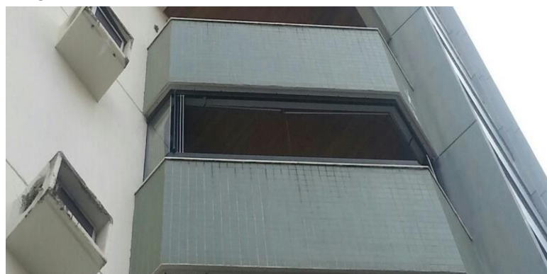
Figura 26: Peitoril de varanda com revestimento cerâmico
