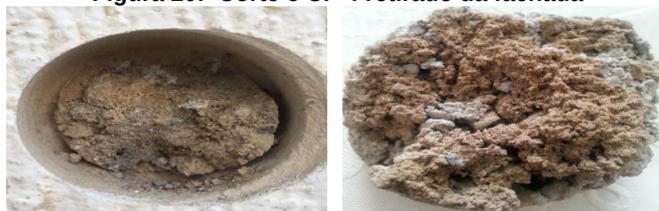
Figura 20: Corte e CP 4 retirado da fachada
