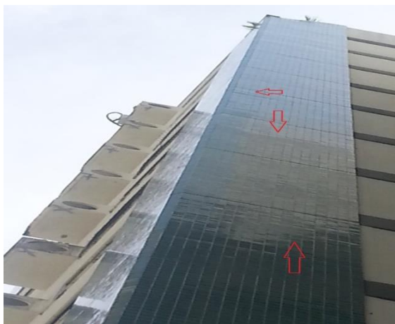
Figura 23: Trechos de um painel com estufamento
