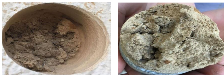
Figura 17: Corte e CP 7 retirado da fachada
