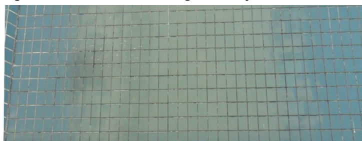
Figura 28: Detalhe de uma região com juntas deterioradas
