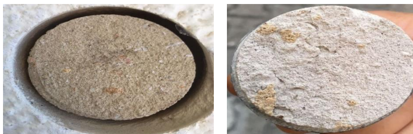
Figura 16: Corte e CP 1 retirado da fachada
