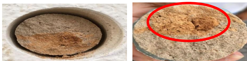
Figura 19: Corte e CP 3 retirado da fachada
