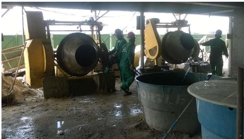
Figura 7 – Central de produção de argamassa no canteiro
