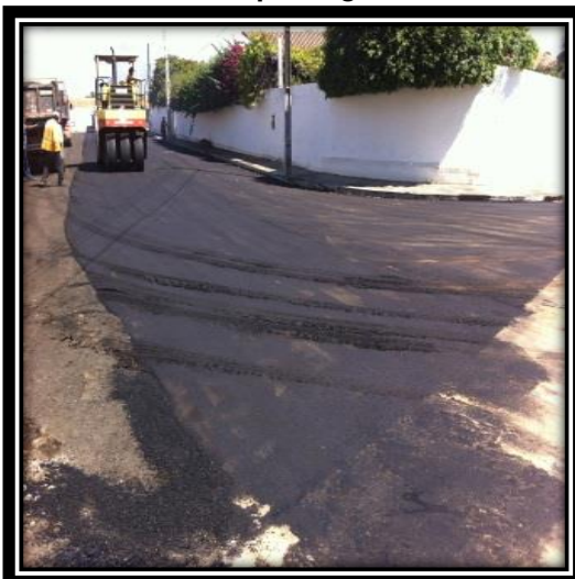
Figura 45 - Rastro de passagem dos caminhões.
