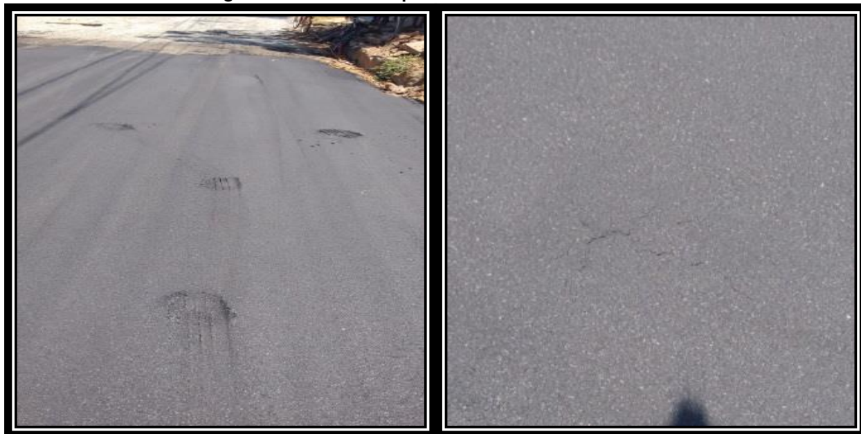
Figura 48 - Fissuras e panelas no asfalto acabado.
