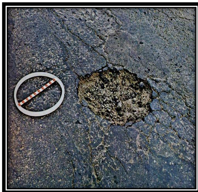
Figura 12 - Panela ou buraco.
