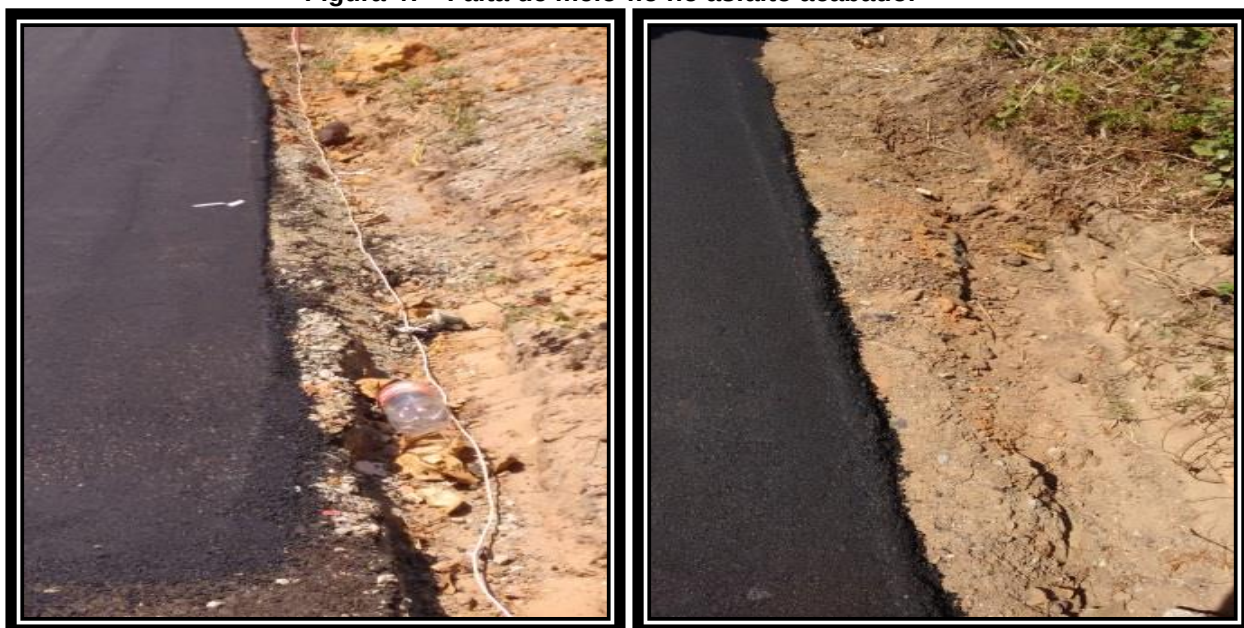
Figura 47 - Falta de meio-fio no asfalto acabado.
