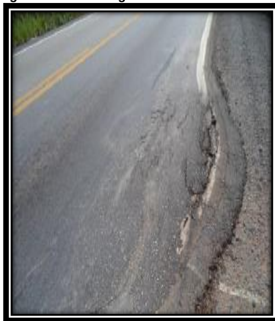
Figura 14 - Escorregamento do revestimento.
