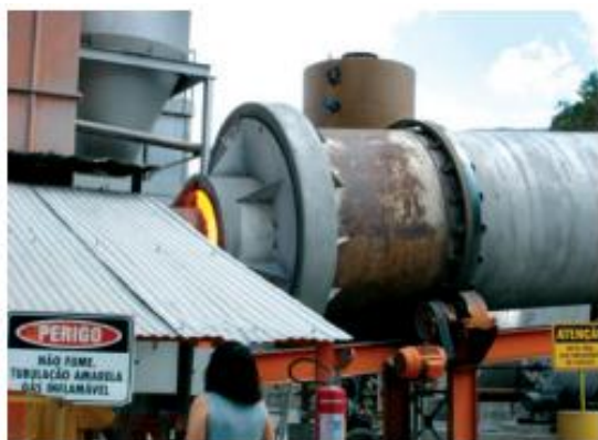
Figura 3.4 - Sistema de Aquecimento do Secador
