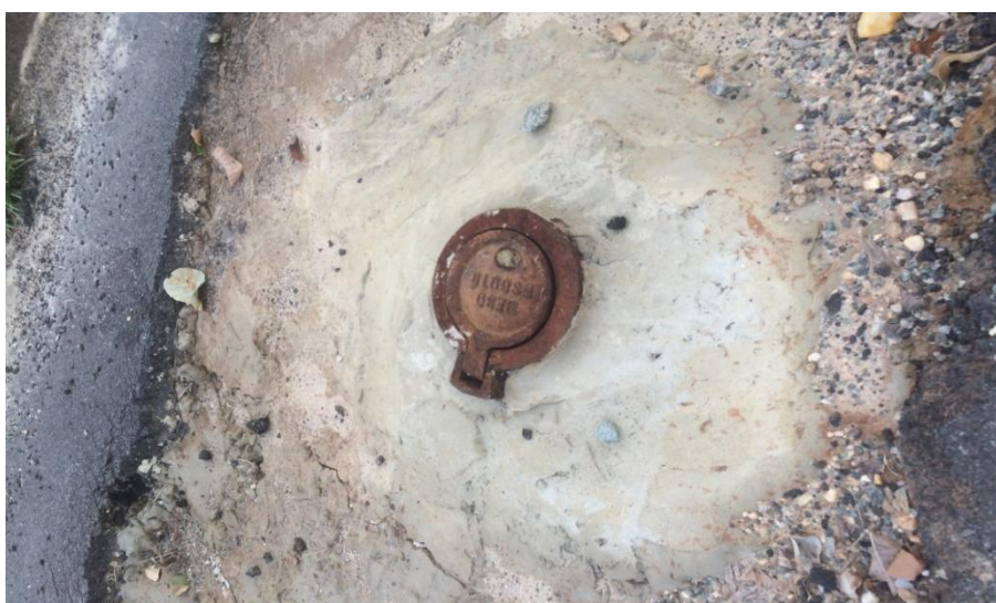
Figura 6.11 - Má execução do recapeamento
