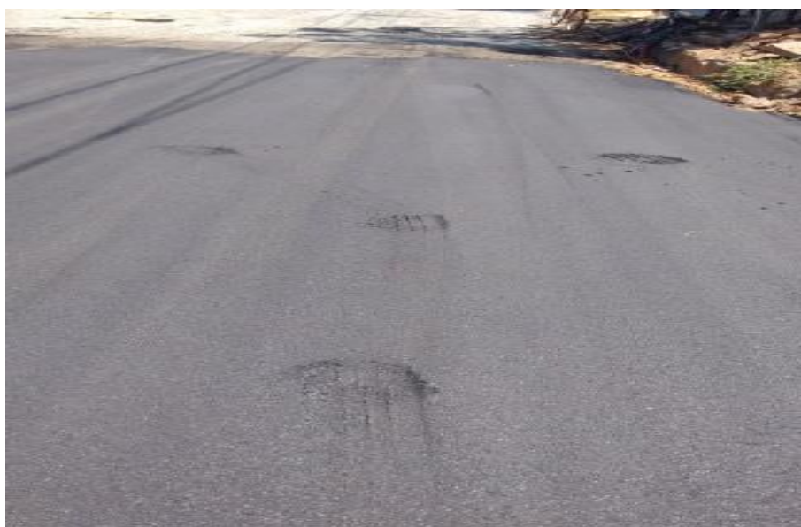
Figura 6.8 - Desgaste em asfalto recém aplicado
