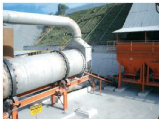
Figura 3.5 - Secador de Agregados com Ventilador de Exaustão
