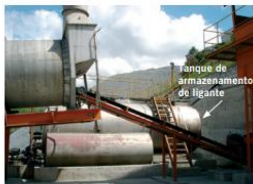
Figura 3.2 - Exemplo de tanques horizontais para armazenamento com aquecimento de ligantes asfálticos de uma usina gravimétrica
