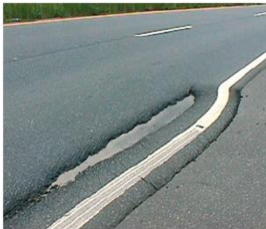
Figura 4.11 - Escorregamento de Revestimento
