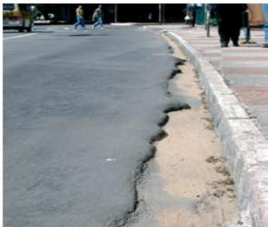
Figura 4.10 - Escorregamento de Massa
