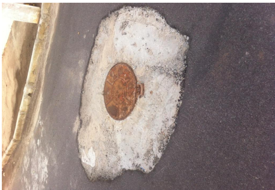
Figura 6.12 - Má execução de recapeamento em torno do pv
