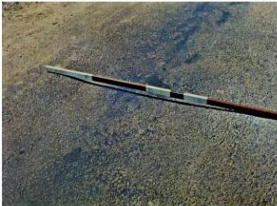
Figura 4.8 - Afundamento de Consolidação
