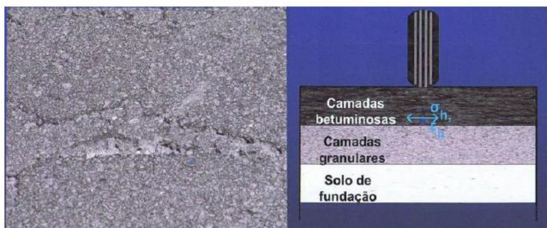
Figura 4.1 - Fendilhamento das Camadas Betuminosas
