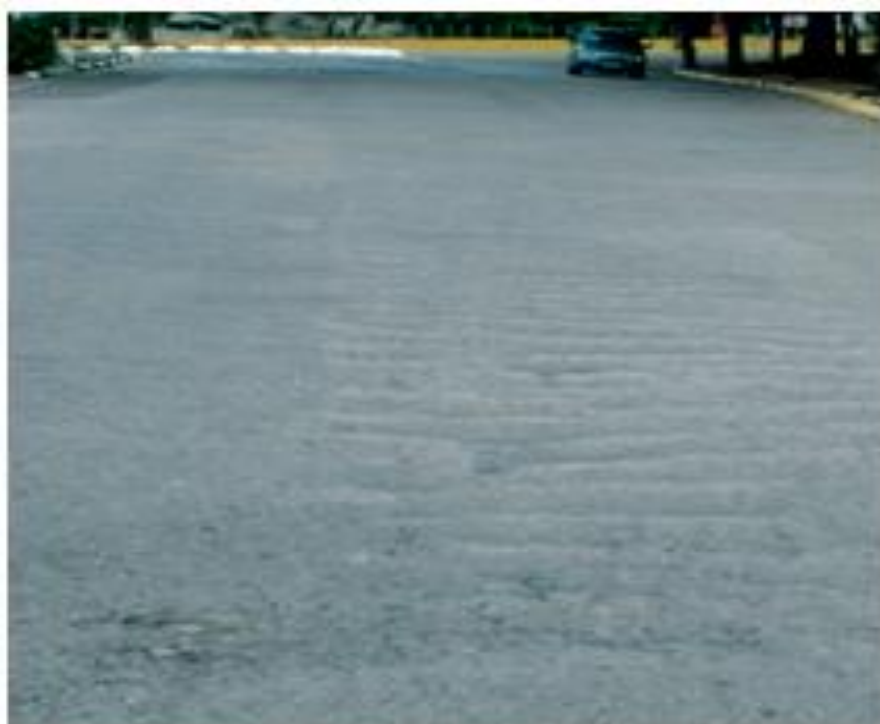
Figura 4.9 - Ondulações ou Corrugações
