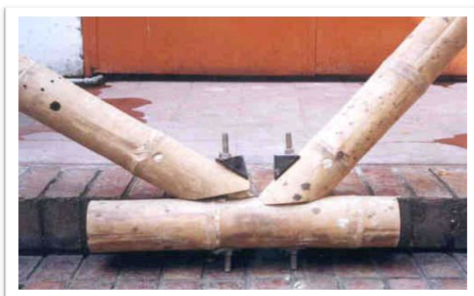
Figura 28 - Ruptura da conexão SV 45° devido à tração. Fonte: Pereira (2001)
