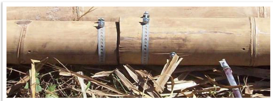
Figura 42 - Uso de braçadeiras de aço evitando o aparecimento de fissuras. Fonte: Pereira (2001)
