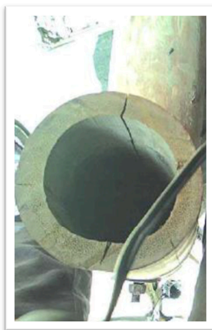
Figura 35 - Ruptura da Conexão SV 90° por compressão. Fonte: Pereira (2001)
