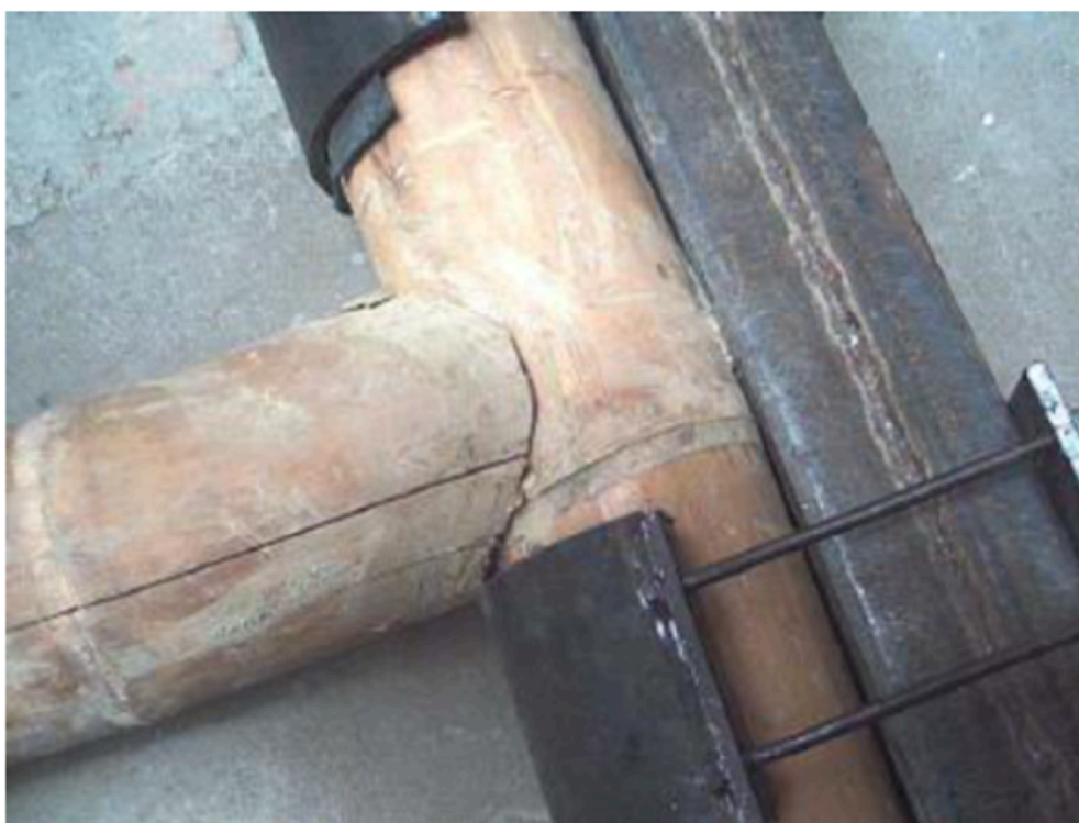
Figura 33 - Ruptura da Conexão SV 90° por compressão. Fonte: Pereira (2001)
