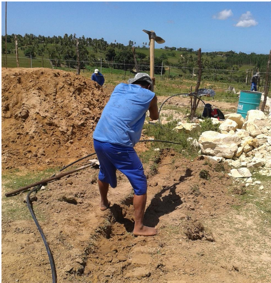
Figura 21 - Execução do Serviço sem o uso dos EPI's - 01
