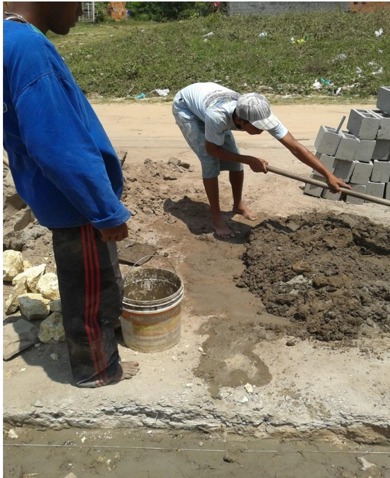
Figura 22 - Execução do Serviço sem o uso dos EPI's - 02
