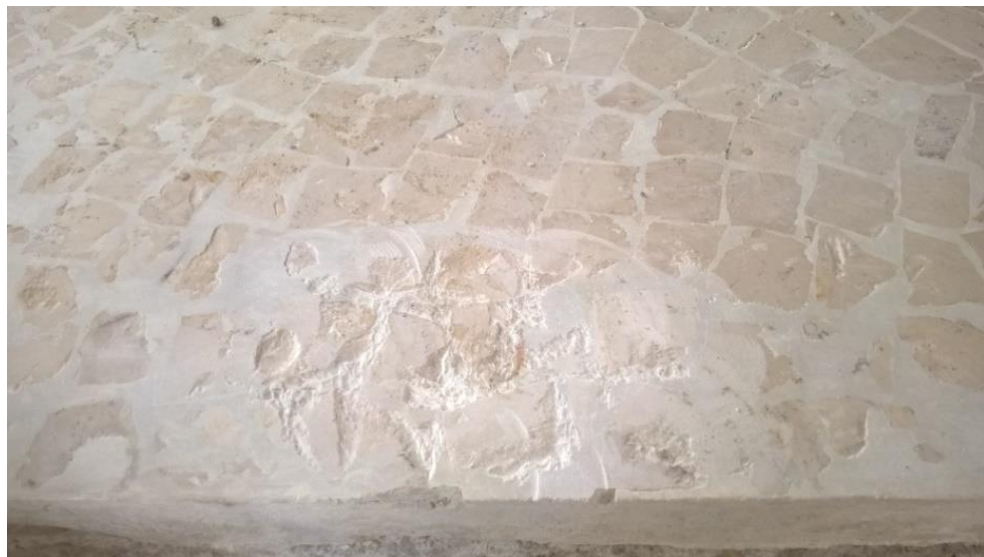
Figura 17 – Brocas formadas pelo maquinário
