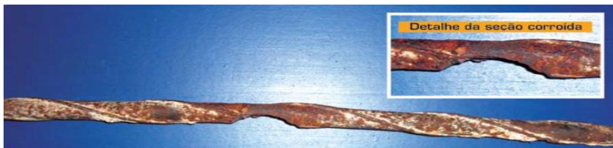
Figura 6 - Barra com corrosão localizada
