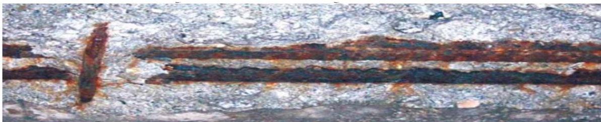
Figura 5 - Armadura com corrosão generalizada
