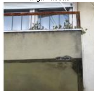
Figura 10: Lacunas nas argamassas
