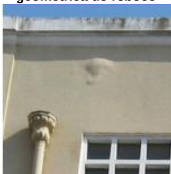
Figura 8: Deformação na geométrica do reboco
