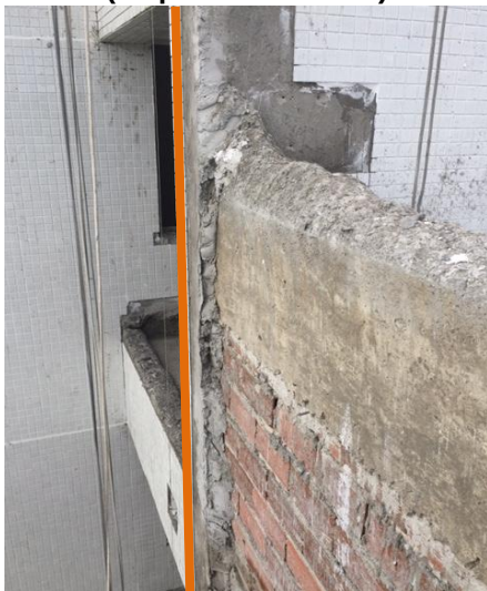
Figura 20: Diferença de espessura (empreendimento 2)
