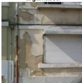
Figura 9: Desprendimento da argamassa
