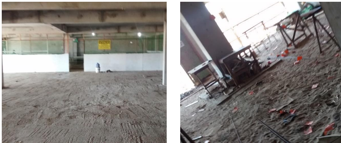
Figura 30 – Resíduo espalhado pela obra no canteiro da Empresa A
