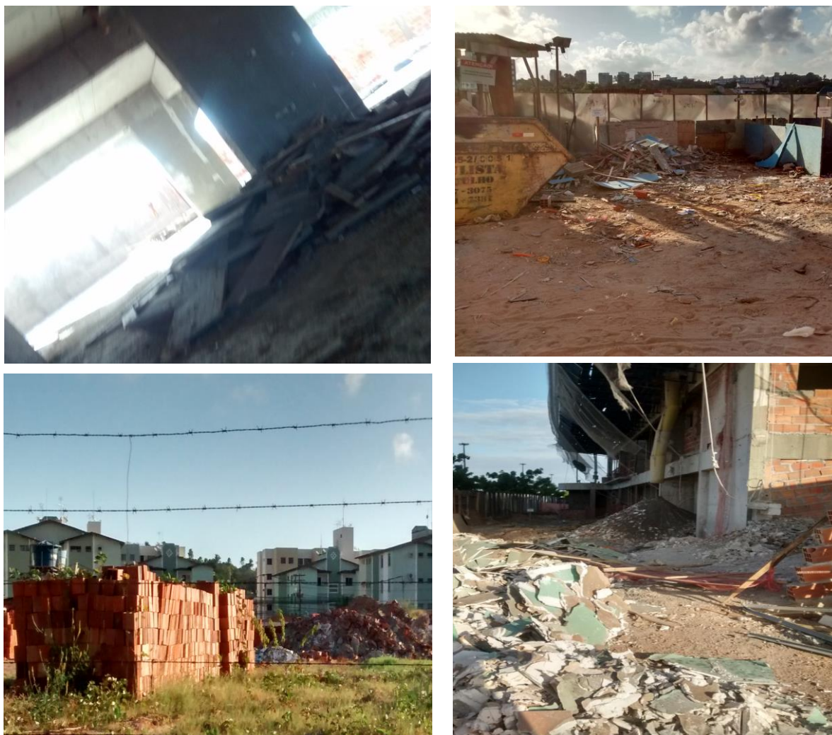
Figura 31 – Resíduo espalhado pela obra no canteiro da Empresa B
