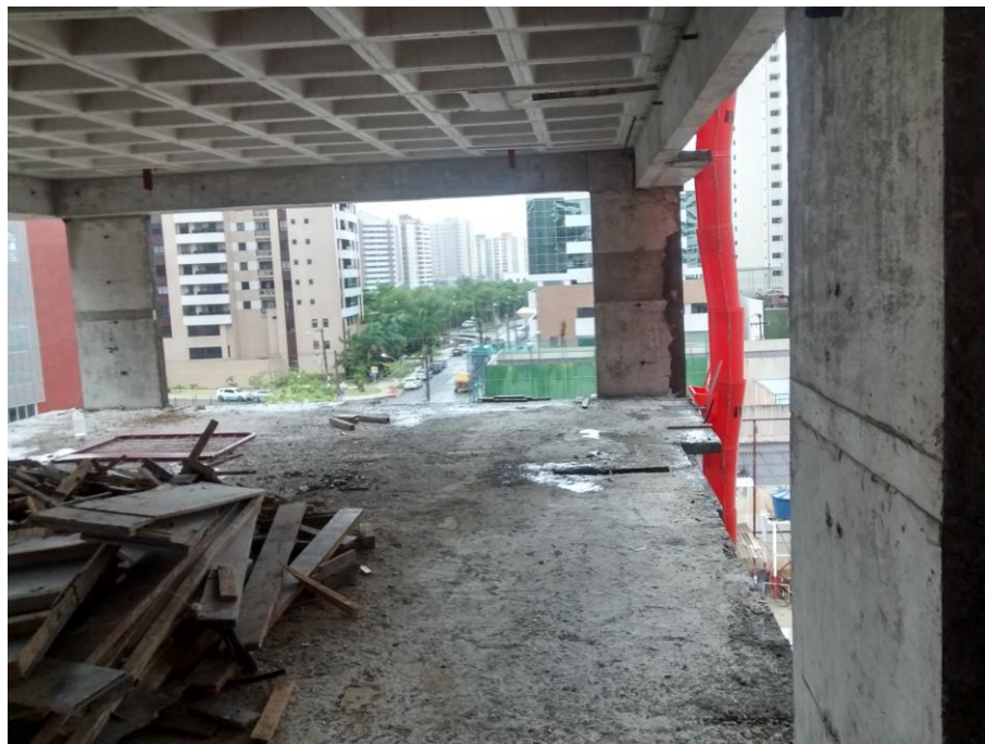
Figura 22 – Ausência de proteção na periferia no Canteiro da Empresa C
