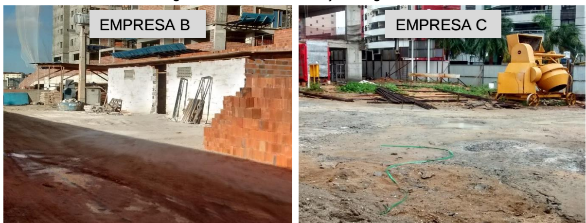
Figura 25 – Vias de Circulação Irregulares
