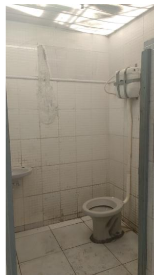
Fotografia 3 – Inexistência de equipamentos.
