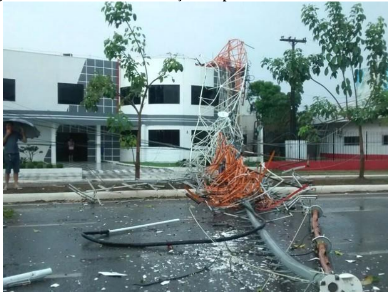
Figura 2 - Torre de Telecomunicação colapsada em Porto Velho -Rondônia
