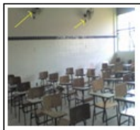
Figura 68- Ventiladores ligados. Fonte: Rosana R. Siqueira, 2012.
