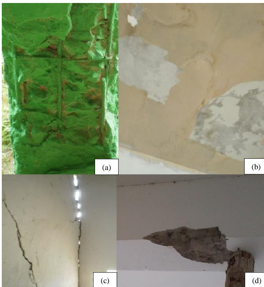
Figura 3. Demonstração de manifestações patológicas. (a) Pilar com ferragem exposta, (b) Laje com manchas, (c)
