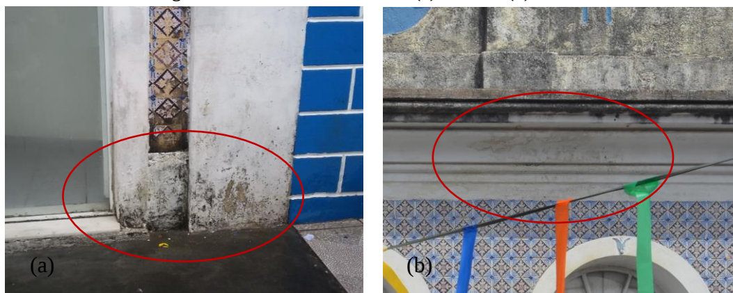
Figura 26 - Mancha de umidade (a) Caso 01 (b) Caso 02
