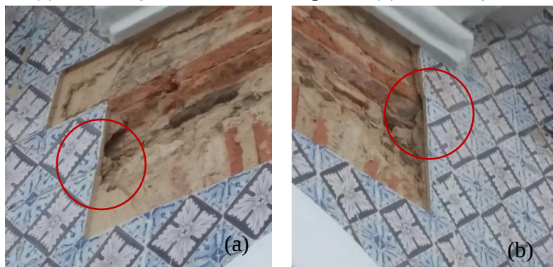
Figura 33 – (a) Deterioração do reboco lado esquerdo, (b) Deterioração do reboco lado direito
