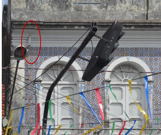
Figura 31 – Os efluentes da calha são despejados diretamente sobre os azulejos
