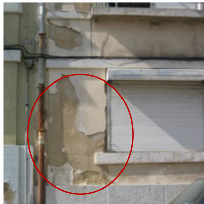
Figura 5 - Exemplos de destacamento em revestimentos argamassados.
