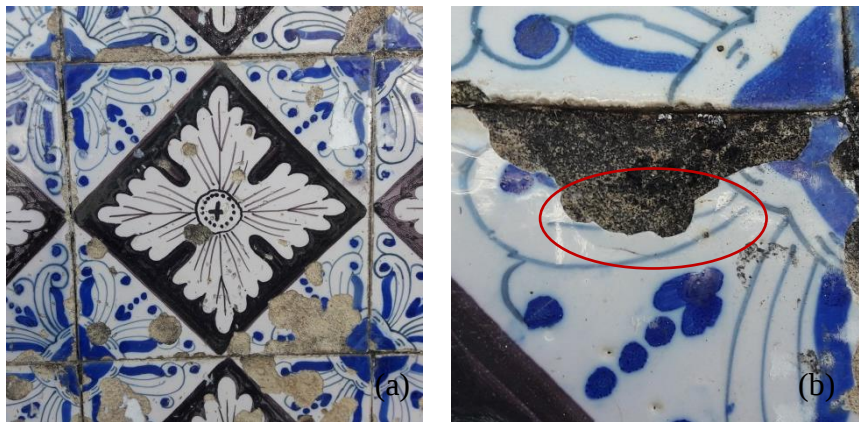
Figura 38 – (a) Azulejo com perda do vidrado por descasque, (b) Desprendimento do vidrado da chacota
