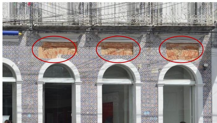
Figura 32 – Destacamento dos azulejos
