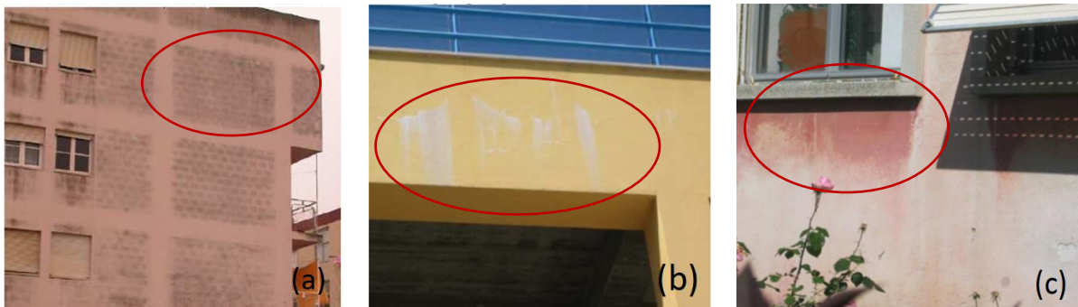
Figura 7 – Exemplo de manchas em revestimentos argamassados, (a) fantômes, (b) eflorescência e (c) alteração cromática
