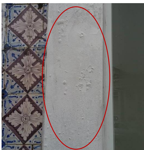
Figura 27 – Vesículas encontradas no revestimento nos pilares
